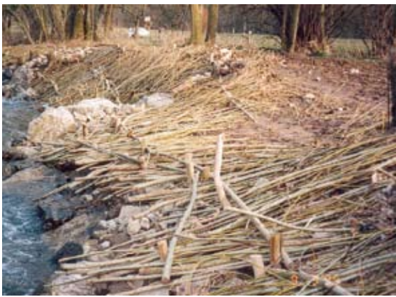
Abb. 4.10: Falscher Einbau: fehlende Einbindung der unteren Ästen an der Uferlinie (Seitengerinne der Enz in Unterriexingen)
