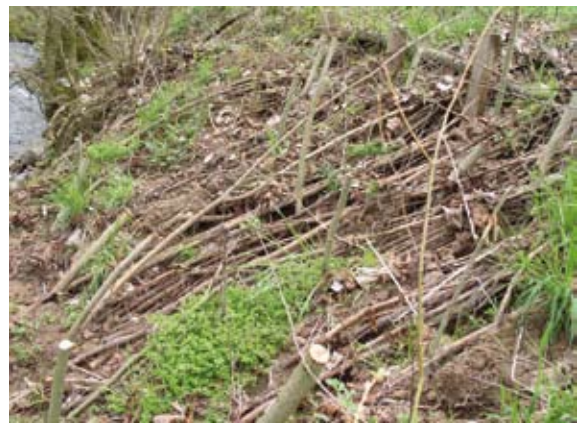
Abb. 4.11: Unterspülte Spreitlage. Ursache: ungenügender Dekungsgrad der Weidenruten (Glems in Münchingen)
