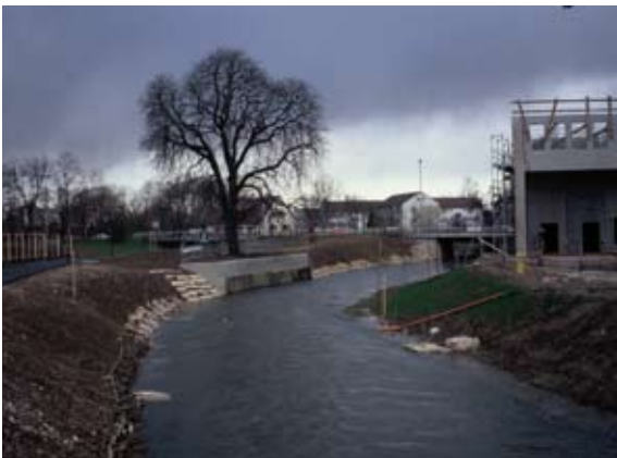
Abb. 3.19: Krainerwand und begrünte Steinschüttung (linkes Ufer) und Weidenfaschinen (rechtes Ufer) nach Fertigstellung
