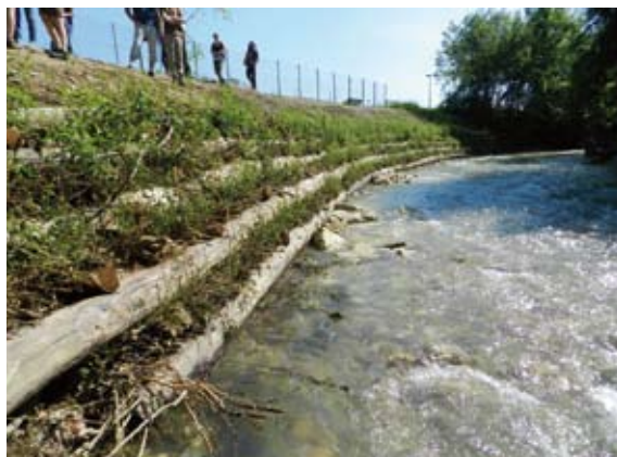
Abb. 4.33: Austrieb einer Krainerwand vier Wochen nach Einbau (Lindach bei Kirchheim/Teck)
